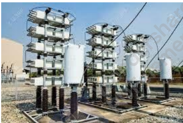
Figura 4-41 Banco de capacitores de la estación.
