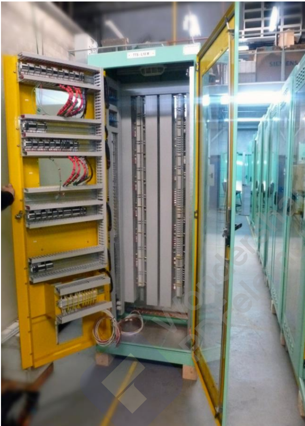
Figura 9-5 Equipo de comunicaciones.
