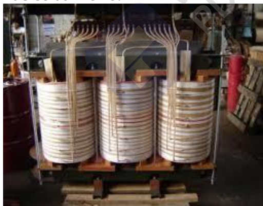
Figura 4-6 Núcleo y bobinas del transformador.
