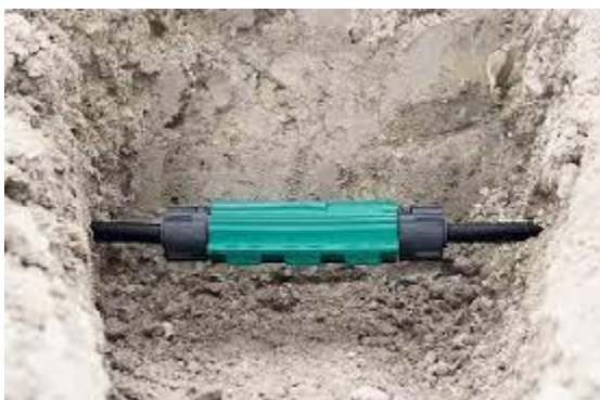
Figura 5-33 Empalme subterráneo primario 3M.
