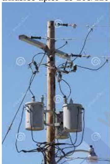
Figura 5-18 Banco de transformadores trifasicos
