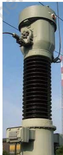
Figura 4-12 HV CT Externo
