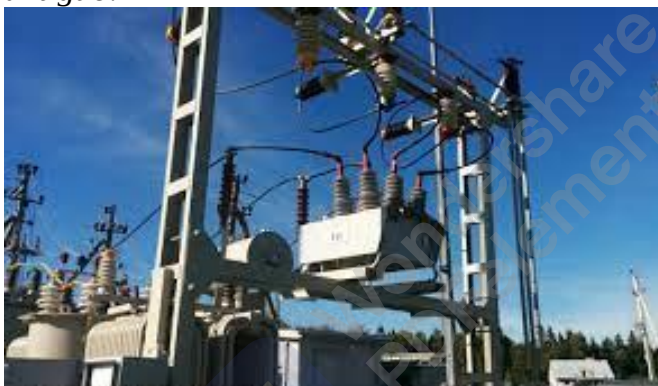
Figura 4-33 Reconectador de Subestación más antiguo.
