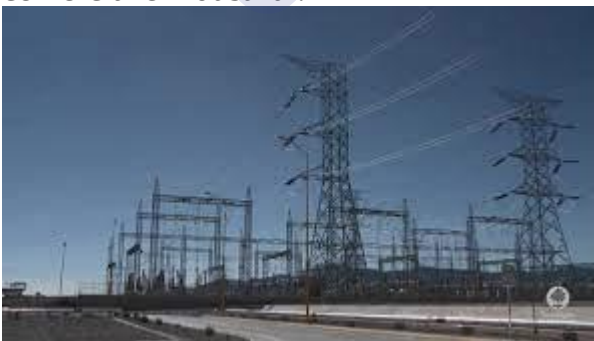
Figura 5-1 Subestación de distribución.
