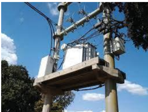
Figura 4-42 Banco de capacitores de distribución.
