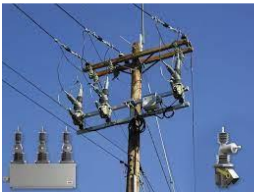
Figura 4-32 Reconectador de líneas de distribución más antiguo.
