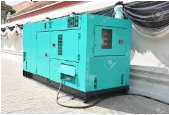
Figura 6-22 Generador de emergencia.
