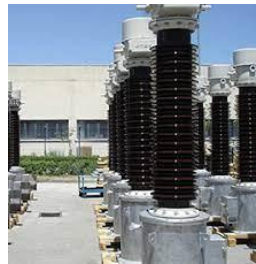
Figura 4-15 PT de alta tensión Cortesía de Alliant Energy
