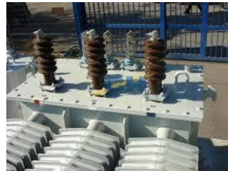
Figura 4-8 Bushing de transformador.
