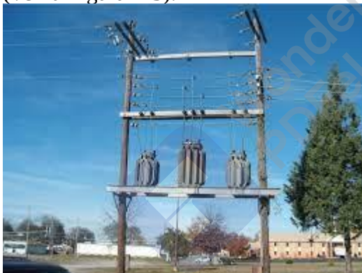
Figura 4-3 Banco de transformadores.
